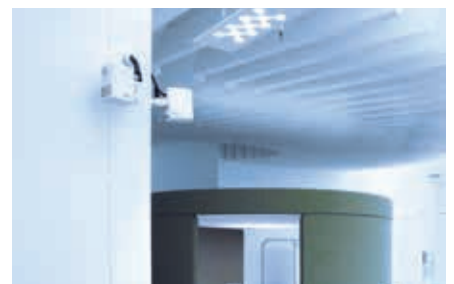
Das Luftbefeuchtungssystem DRAABE NanoFog Evolution im Fraunhofer IAÖ
